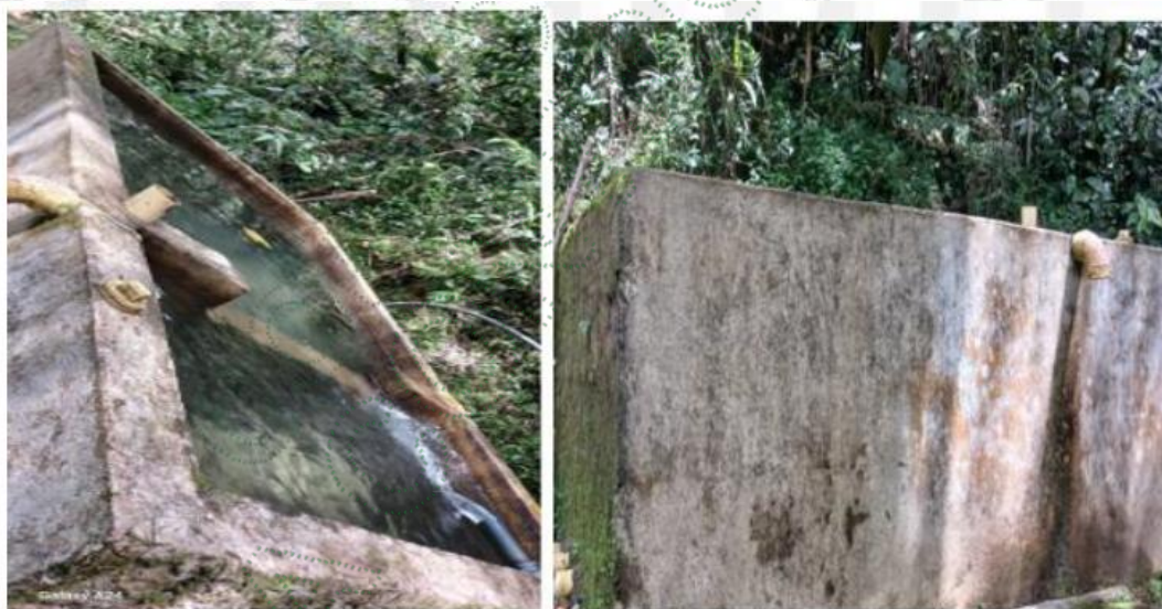
Imagen 7 y 8 tanque de almacenamiento y desarenador
