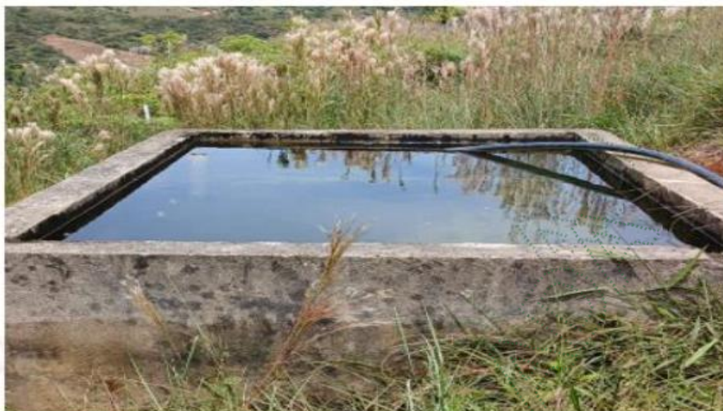
Imagen 9 tanque de almacenamiento
