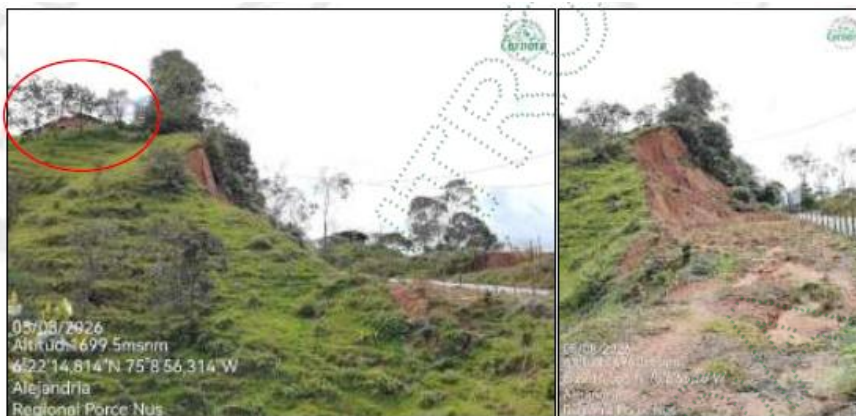
Imagen 3. Cornare 2026. Estado del talud y vivienda ubicada en la parte alta del talud.
