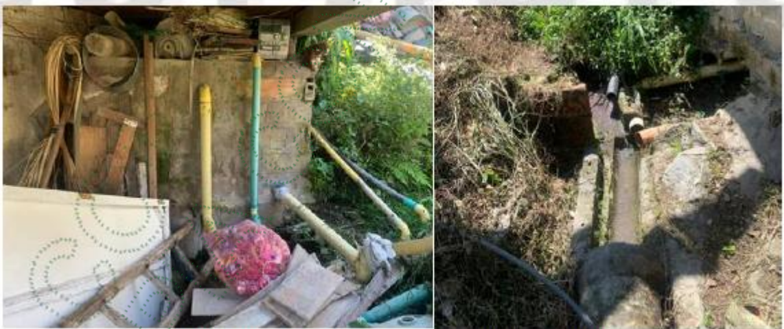
Figura 4. Sistema séptico y descarga a cuneta en cemento
