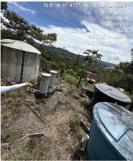
Almacenamiento y PTAP común
