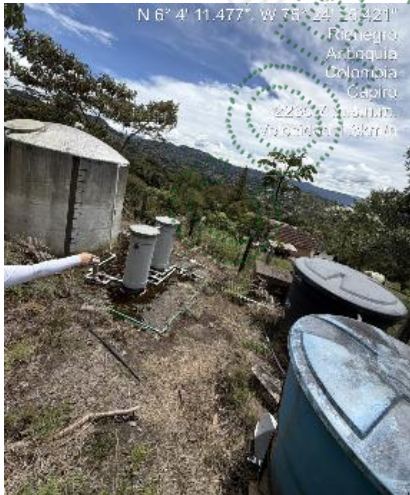
Almacenamiento y PTAP común
