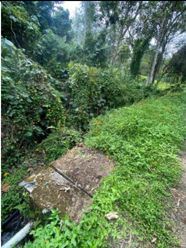
Figura 5. Tanque sedimentador - Almacenamiento
