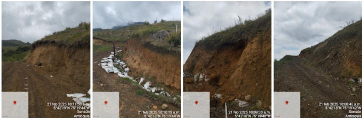
Pendientes de talud superiores a 80°
