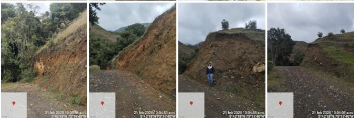
Altura de talud superior a 3 metros y ancho de vía superior a 2 metros
