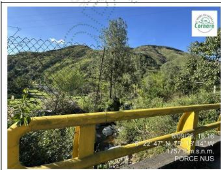
Imagen 2. Estado actual margen izquierdo de la vía.
