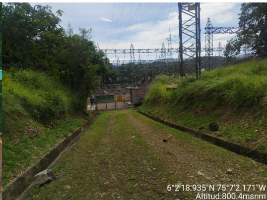
Imagen 2. Subestación de energía San Lorenzo
