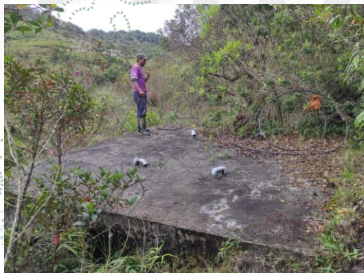
Imagen 4. Tanque de almacenamiento. Cornare 2026.
