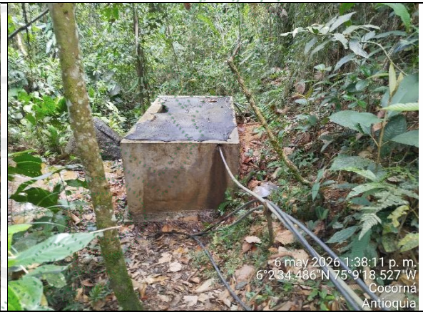
Figura 6. Tanque desarenador y de almacenamiento del sitio
