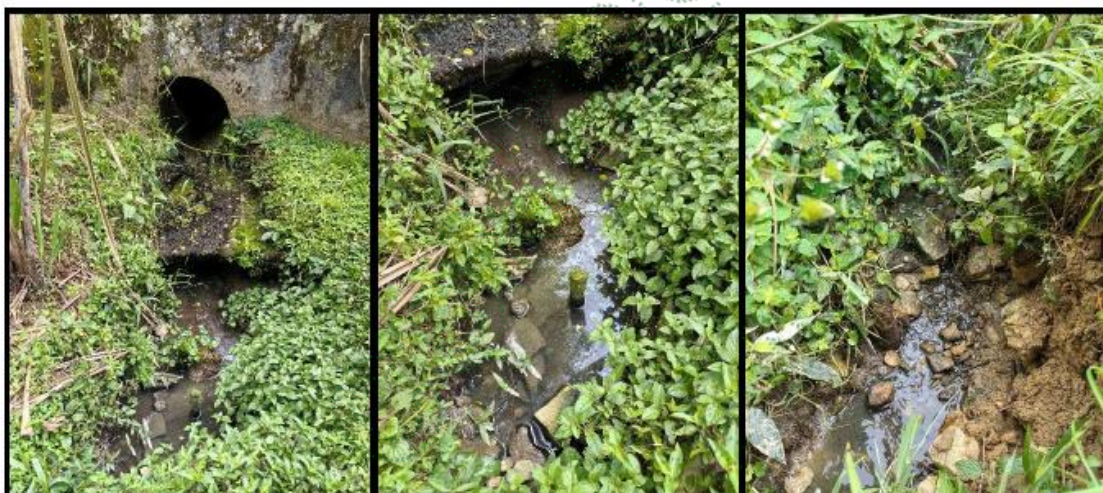
Imagen 1. Cornare. 2026. Continuación de las escorrentías en encauzadas en la finca La Cabaña hacia la parte baja pasando la carretera.
