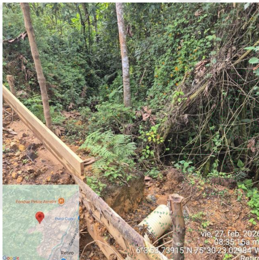
Ilustración 1 Estructura de descarga B3
