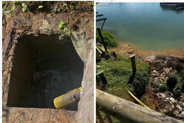
Caja de registro y Punto de descarga. Cornare 2026.
