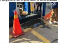
Fotografía 9. Se crea una barrera para evitar la expansión del derrame
