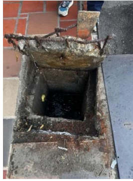
Sistema de Tratamiento de Aguas Residuales. Cornare 2026
