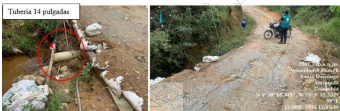
Figura 7. Ocupación de cauce fuente 1
