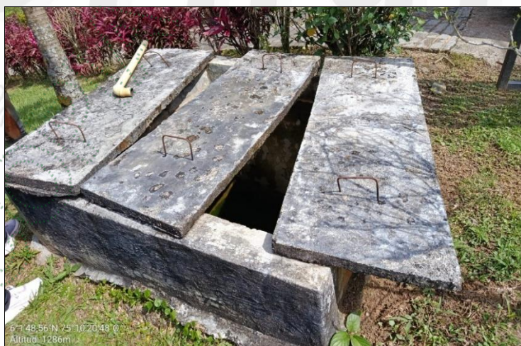
Imagen5. Tanque de almacenamiento uso doméstico Cornare 2026
