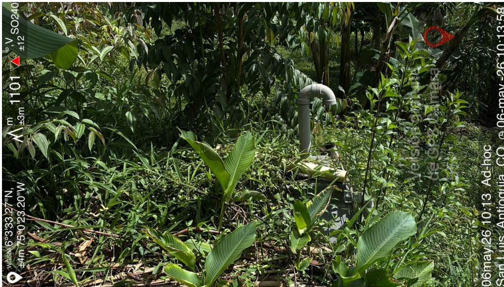
Imagen 3: Pozo séptico vivienda y cocina.
