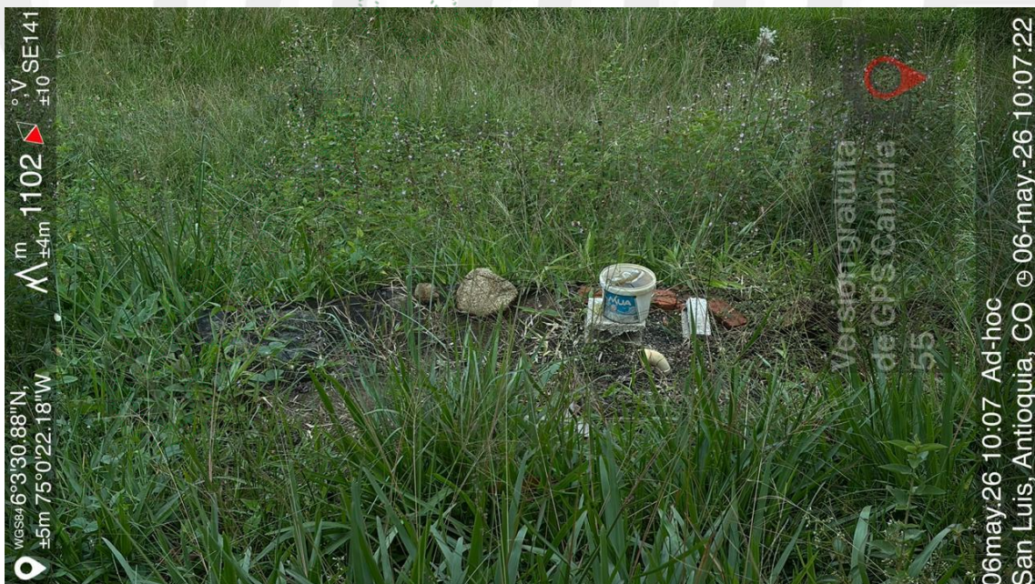
Imagen 2: Pozo séptico cabañas
