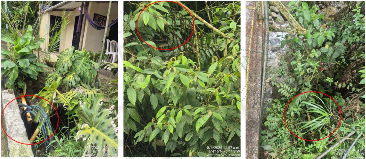
Imagen 6: Tuberías de aguas residuales sobre el cauce de la Q. La Chonta Fuente: Cornare, 2026
