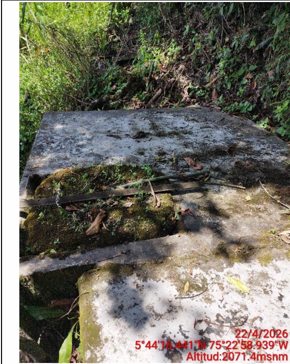
Tanque de almacenamiento
