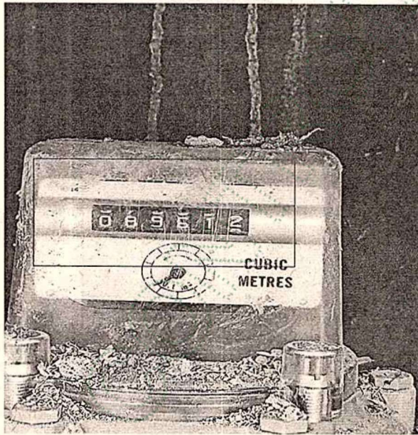
Imagen 4. Lectura medidor externo de gas del día 20/03/2026.
