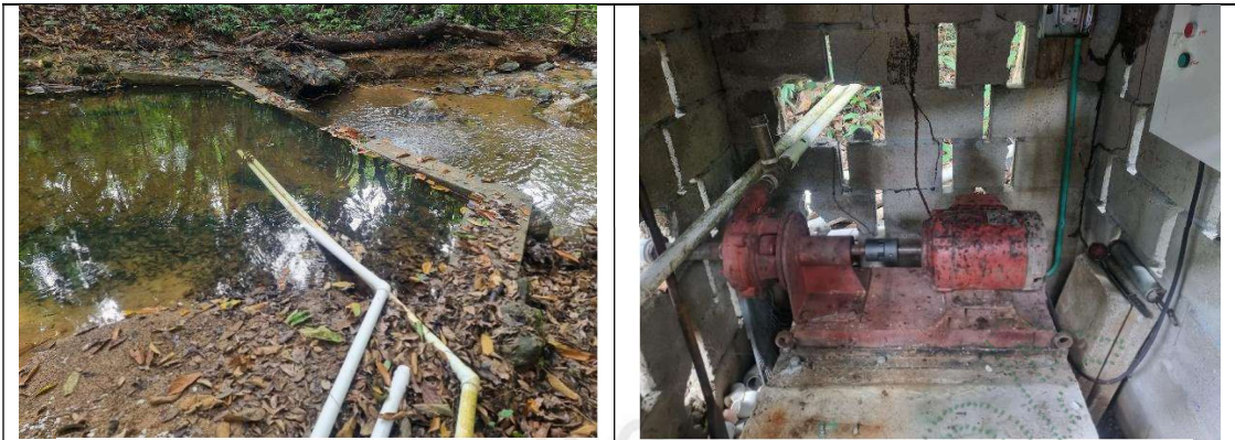
Foto 3 y 4. Punto de captación y sistema de bombeo de la fuente "El Lago". Fuente: Cornare 2026 – Visita de control y seguimiento expediente 18028346.
