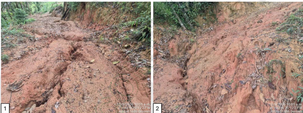
Imagen 1 y 2: Vía con procesos avanzados de degradación del suelo. Se observan surcos profundos y formación de cárcavas longitudinales.
