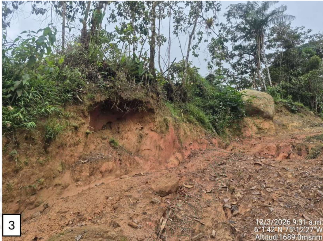
Imagen 3: Talud lateral con pendiente pronunciada y signos de inestabilidad.
