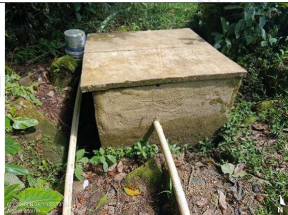
Imagen 6. Tanque secundario. Cornare 2026
