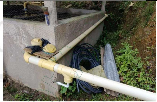
Imagen 4. Tubería adecuada para el desplazamiento del recurso hidrico tratado. Cornare 2026
