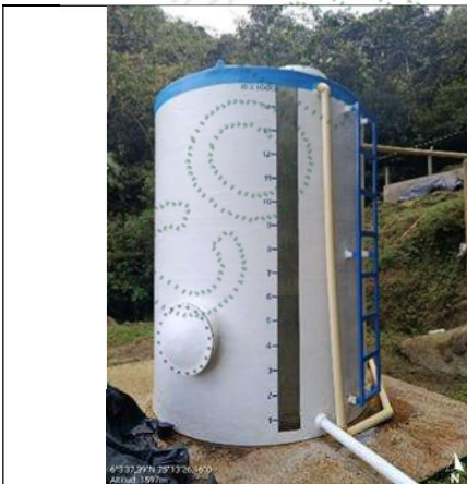
Imagen 5. Tanque de almacenamiento con una capacidad de 15.000 litros. Cornare 2026
