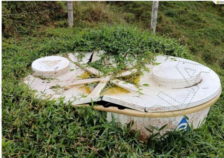
Imagen 5. Condiciones del Tanque séptico en visita técnica realizada el 22 de diciembre de 2025.
