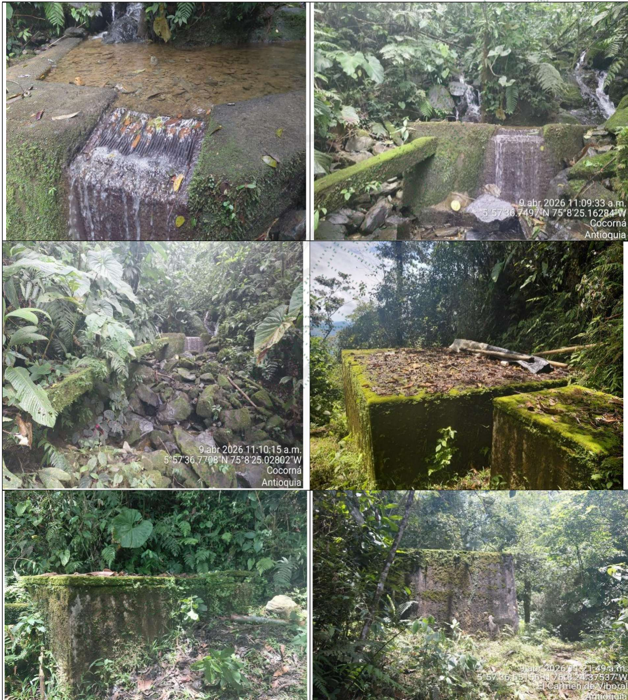
Sistema de captacion, tanque desarenador y de almacenamiento
