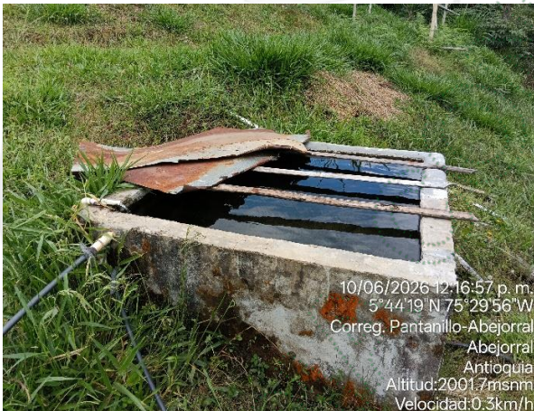
Tanque de almacenamiento # 2
