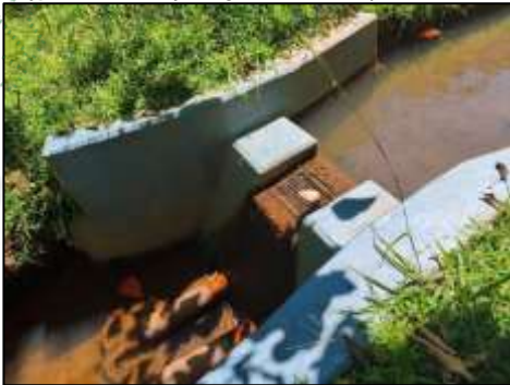
Figura 9. Captación de la fuente “La Noreña”
