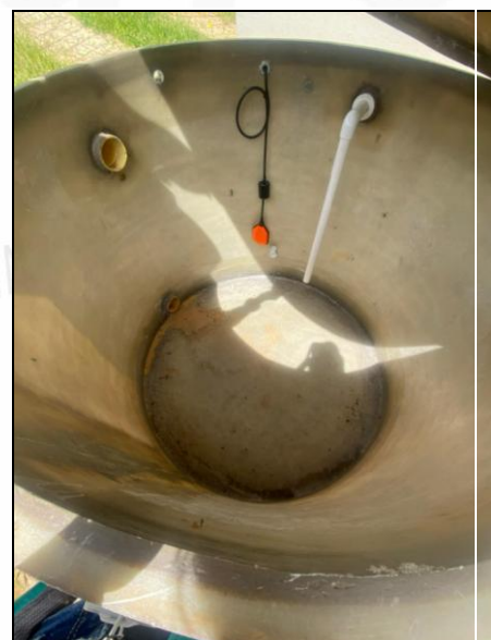
Tanque de igualación
