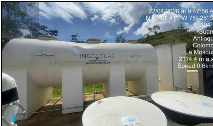
Reactor de lodos, sedimentador y filtro
