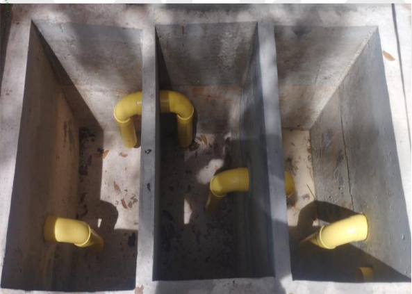
Fotografía 4 Trampa de grasas construido posterior
