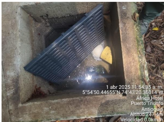
Fotografía 5. Caja de entrada al STARD
