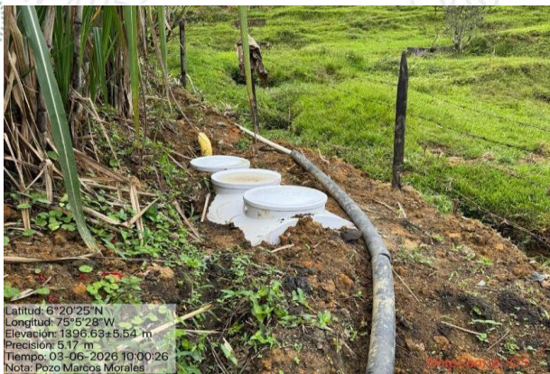
Imagen 8. Pozo séptico vivienda Marco Morales
