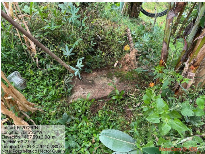
Imagen 5. Pozo séptico vivienda Héctor Guarín.
