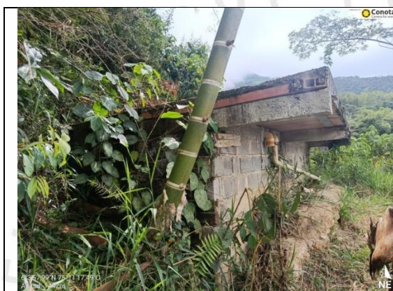
Imagen5. Tanque de Almacenamiento. Cornare 2026
