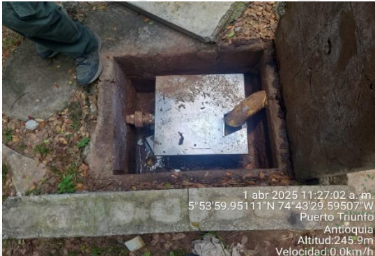
Fotografía 3. trampa de grasas, observado en campo
