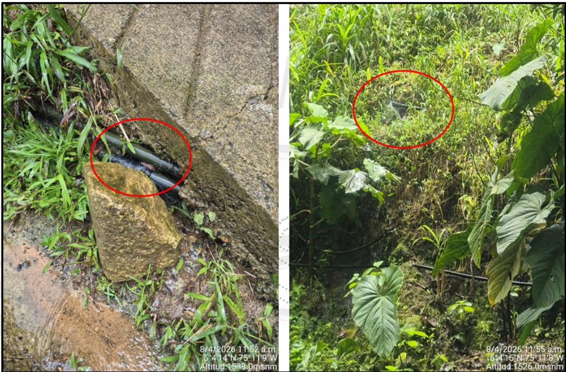
Imagen 3: Mangueras con fugas de agua. Fuente: Cornare
