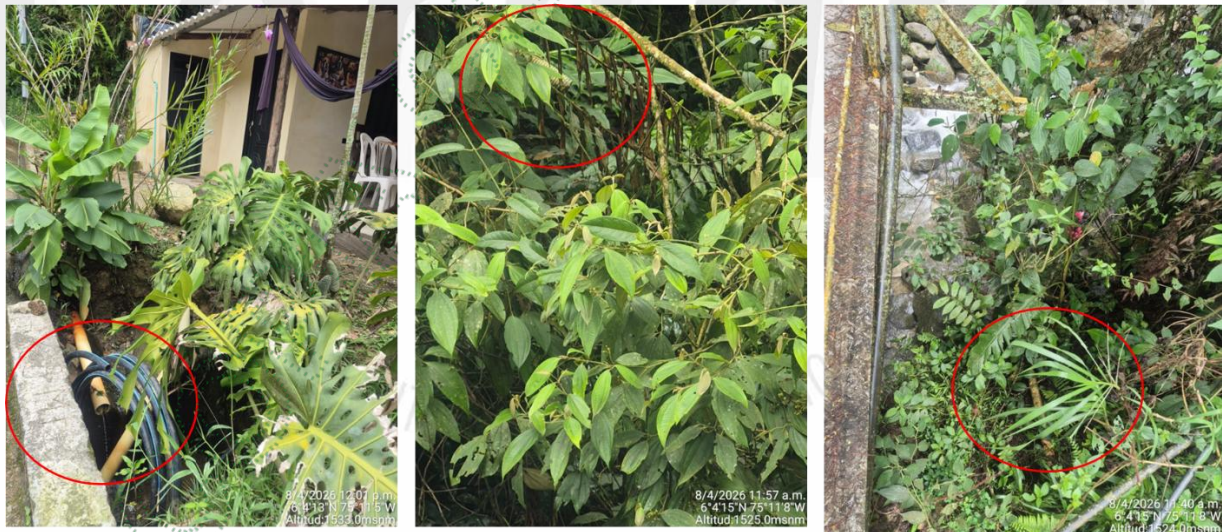
Imagen 1: Tuberías de aguas residuales sobre el cauce de la Q. La Chonta Fuente: Cornare, 2026
