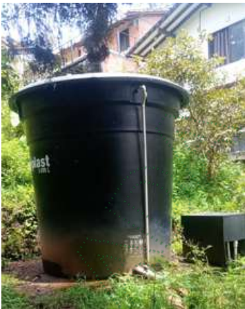
Tanque de Almacenamiento
