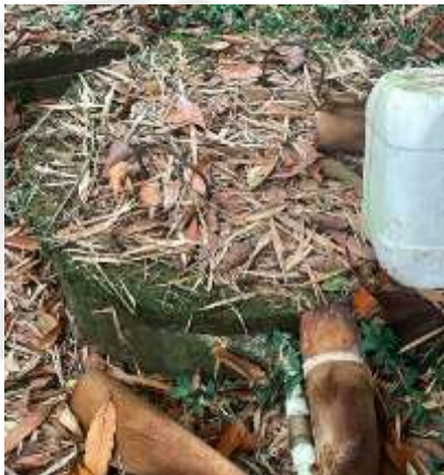
Imagen 9. Tanque de succión-Captación 2
