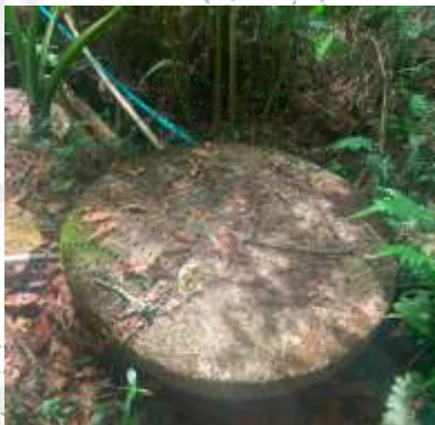
Imagen 7. Tanque de succión-Captación 1
