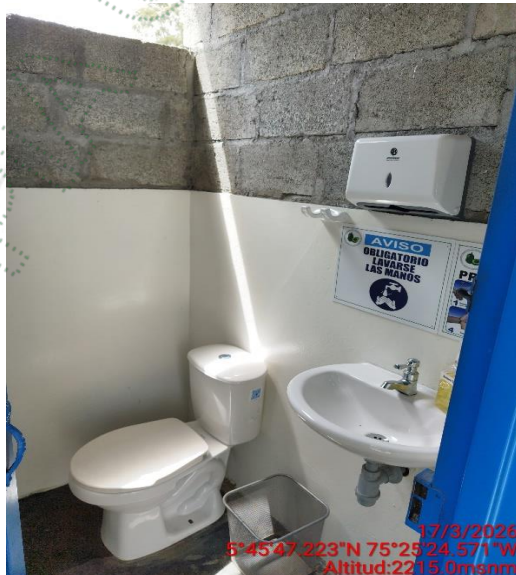
Unidad Sanitaria área Oficinas
