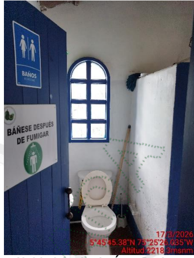
Unidad sanitaria Área Bodega
