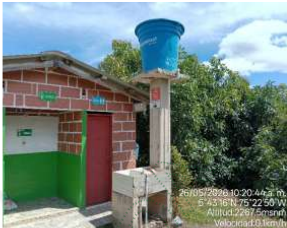
Sistema de Almacenamiento
