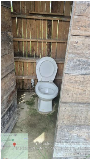
El sanitario y la descarga al suelo sin tratamiento
