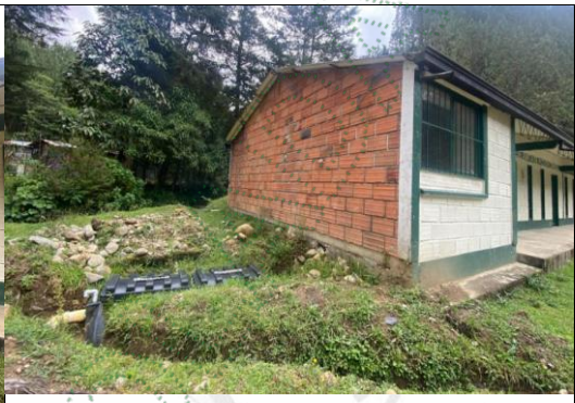
Sistema de Tratamiento de Aguas Residuales Domésticas
