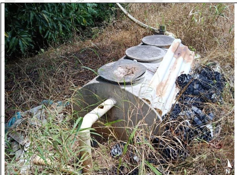
Imagen2. Sistema de tratamiento de aguas residuales del local comercial “Amore mío”. Cornare 2026
