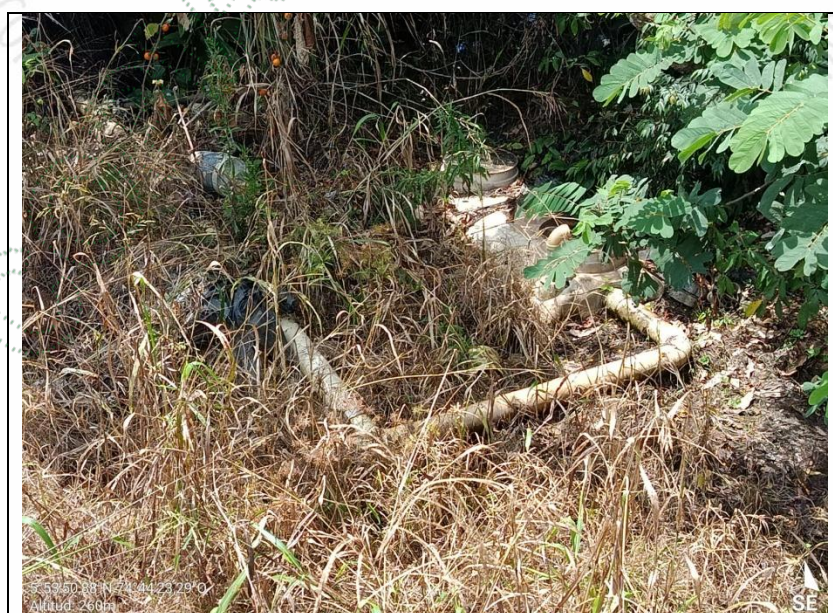
Imagen4. Sistema de tratamiento de aguas residuales de la vivienda del señor Rodrigo de Jesús. Cornare 2026
