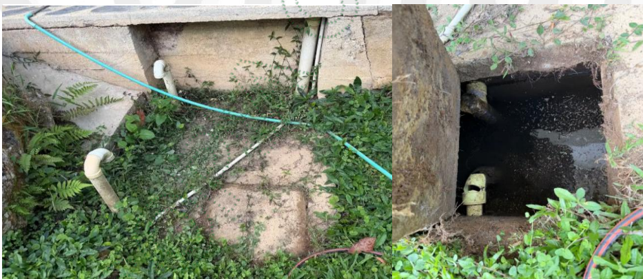
Imagen 3 y 4. Sistema séptico #1 Hotel El Trocadero, vereda El Arenal San Rafael. Cornare 2026.
