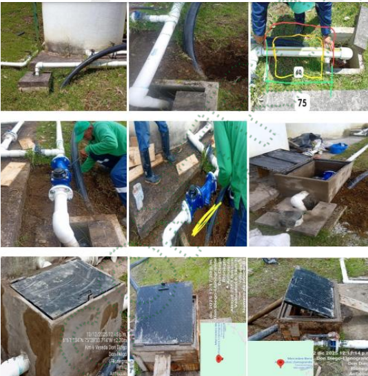
Macromedidor tanques de almacenamiento
