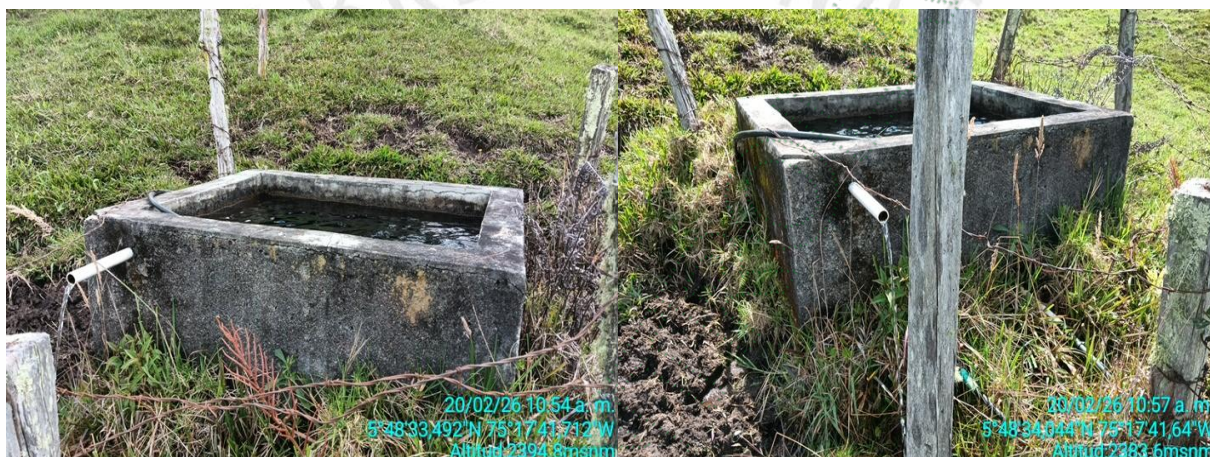
Tanque de almacenamiento
