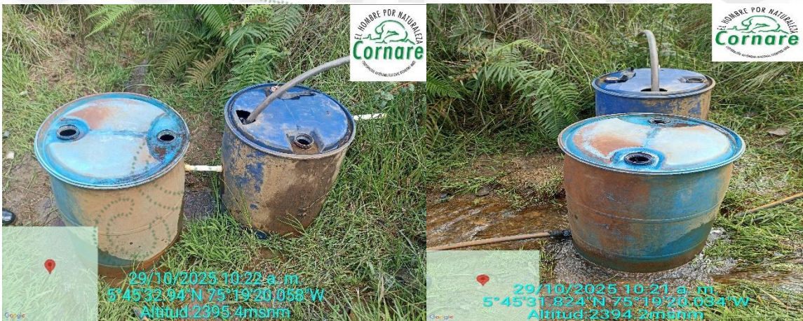
Obra de captación (pendiente ajustes en caudal derivado)
