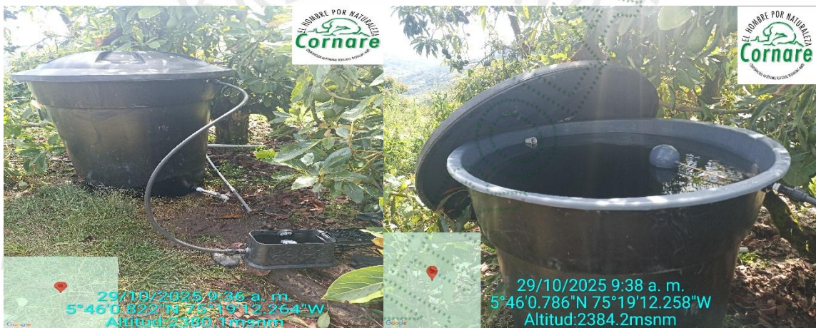
Tanque de almacenamiento de 1.000 litros, con flotador y control de flujo
