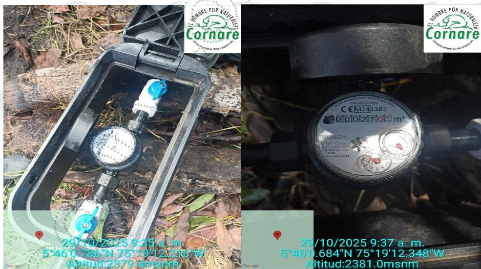
Micromedidor instalado (pendiente lecturas)
