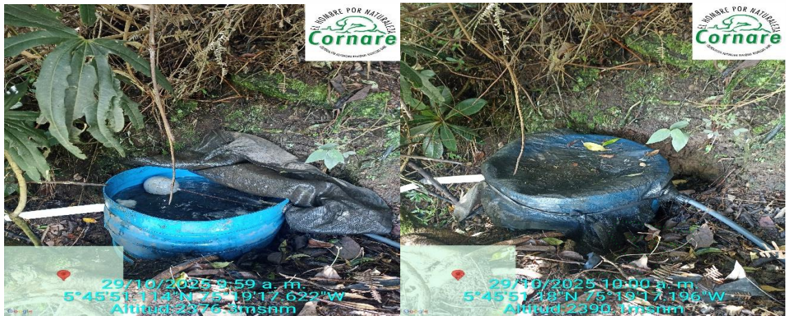
Tanques de quiebre de presión con flotador
