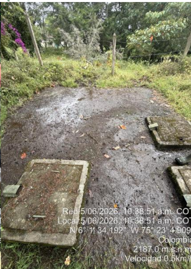
Tanque de almacenamiento
