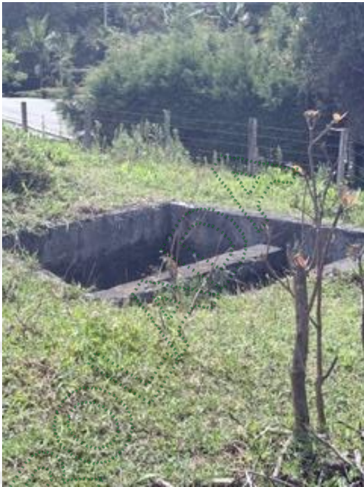
Imagen 4. Tanque de distribución en desuso
