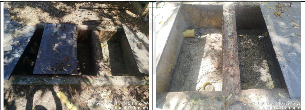
Figuras 2 y 3. Estado actual sistema de tratamiento de aguas residuales domésticas – Unidad preliminar trampa de grasas
