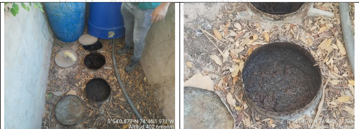
Figura 4. Estado actual sistema de tratamiento de aguas residuales domésticas – Tanque séptico y FAFA
