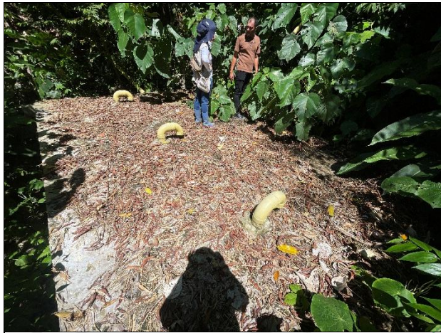
Figura 6. Tanque séptico para las aguas residuales domésticas generadas por dos viviendas y una tienda.
