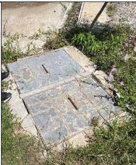
Figura 6. Área de recolección de aguas residuales no domésticas
