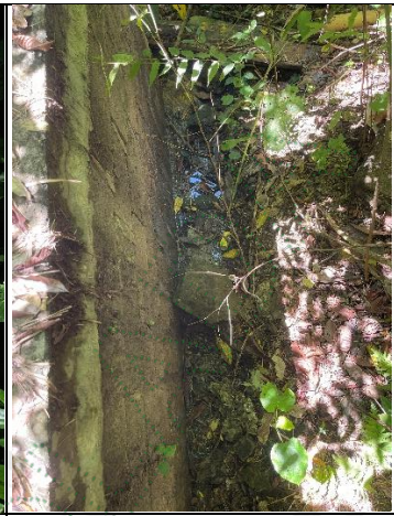
Figura 7. Filtración y vertimiento del pozo séptico al suelo.
