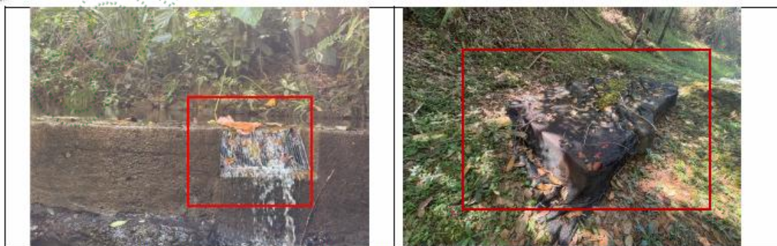
Imagen 3 . Estado de mantenimiento y limpieza de la obra de captación.
