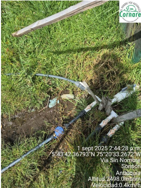
Imagen 5. Tuberías de reparto de la fuente principal.
